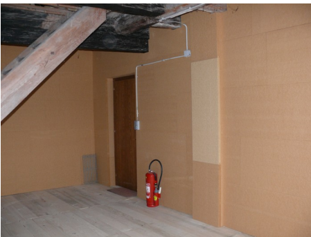
Dämmung im Dachboden
